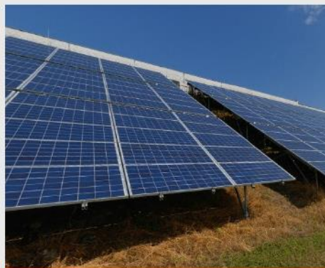
FOTOVOLTAICKÁ ELEKTRÁRNA BUŠTĚHRAD
